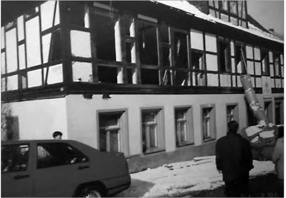
Im entkernten Zustand zeigte das Bauwerk seine Schwachstellen auf - Aufnahme März 1996; Foto: Privatarchiv Familie Lindner.
